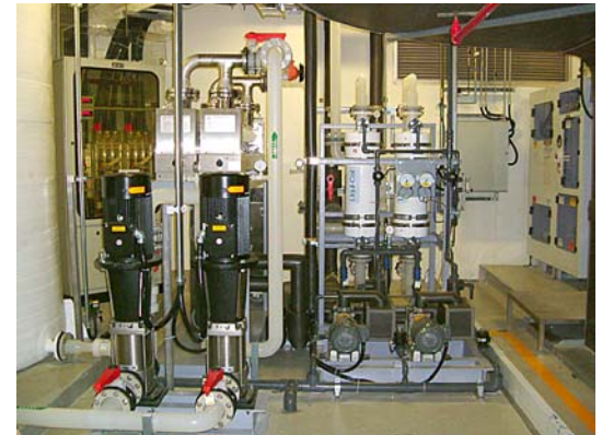
第二ステージ(ポリッシング)の二酸化炭素と酸素除去のリキセル分離膜装置
